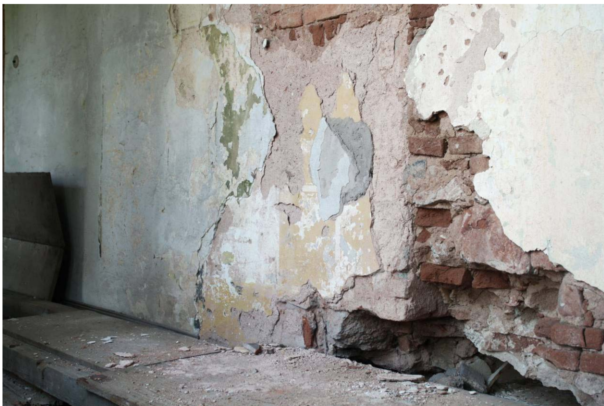
63. Viz 62, detail fragmentu původní raně barokní exteriérové omítky s iluzivní rustikovanou šambránou
