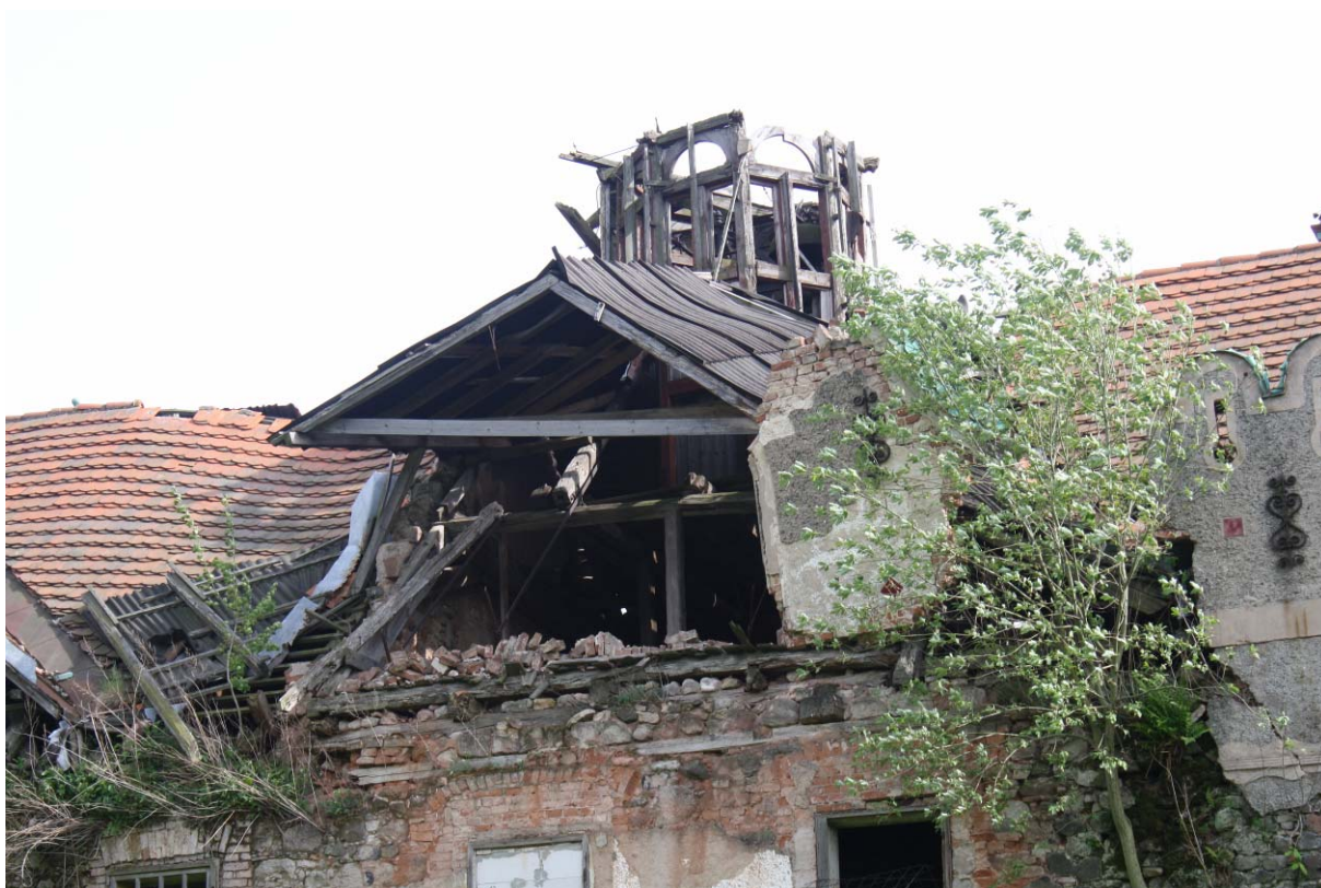
24. Severní průčelí, detail zborceného středového štítu a torza trámové kostry věžičky
